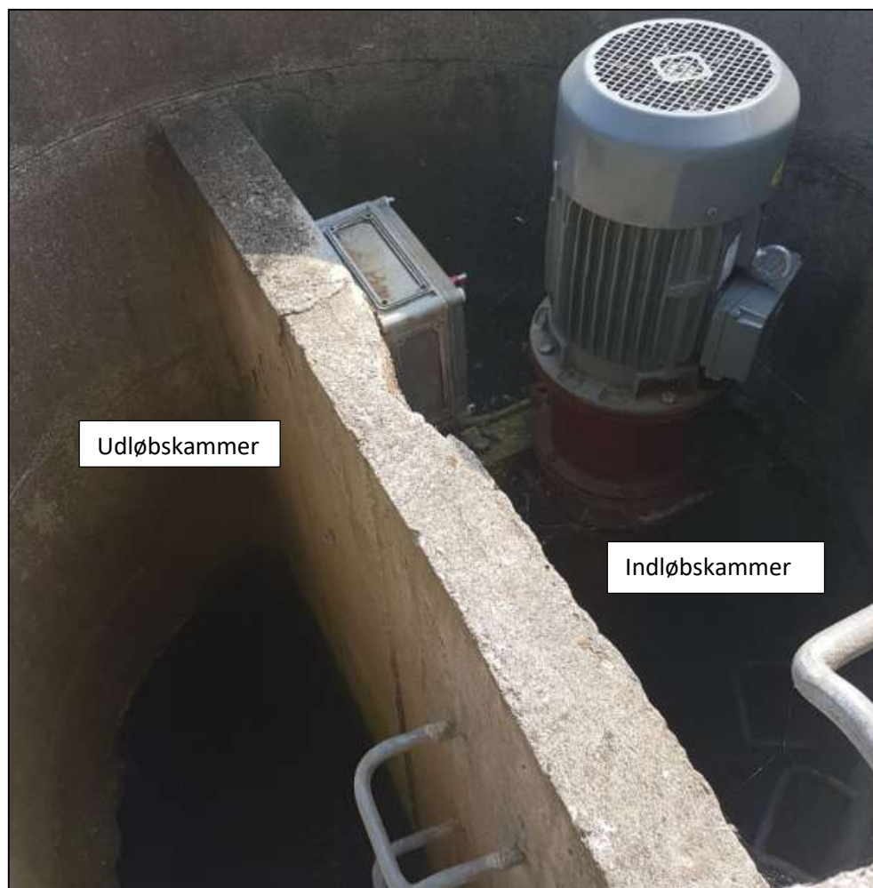
Figur 14: Pumpestation i afvandingsystem 2, der afvander til Vindinge Å.
