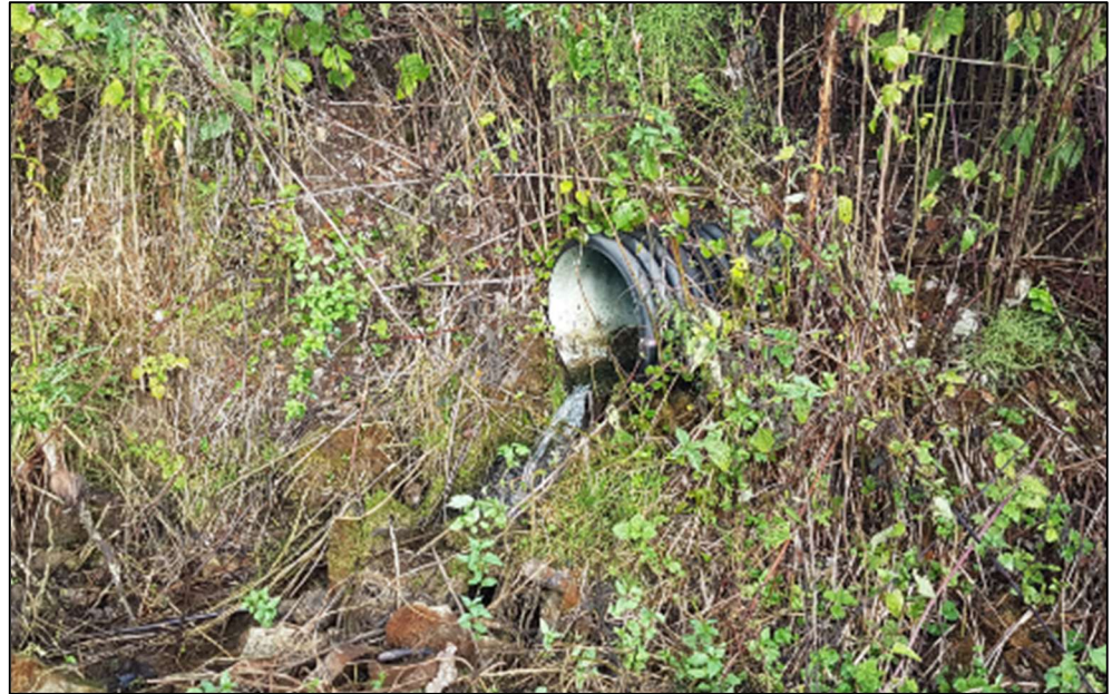
Figur 22: Udløb i afvandingsystem 8 med kraftig vandføring.
