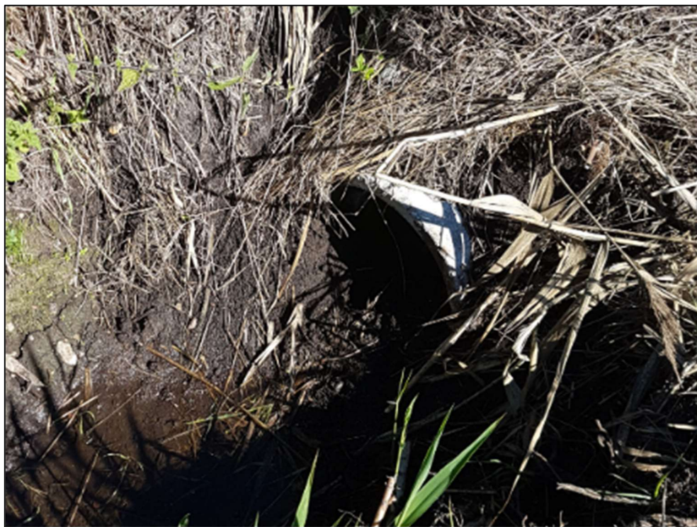
Figur 21: Overkørsel i afvandingssystem 7.
