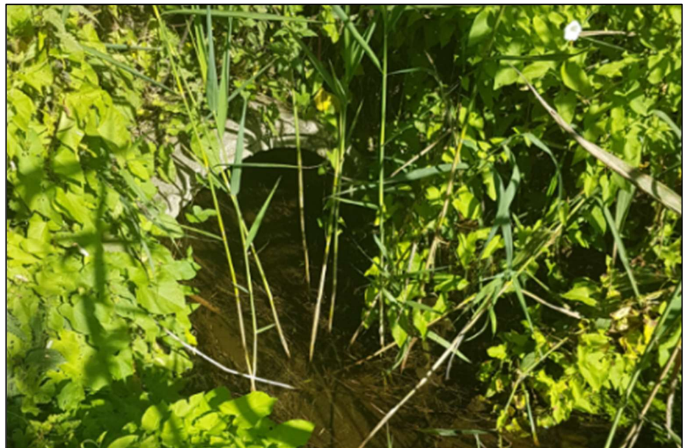
Figur 9: Rørlægning af Kogsbølle Bæk under Sludevej ved st. 903 m (regulativ st. 834 m).
