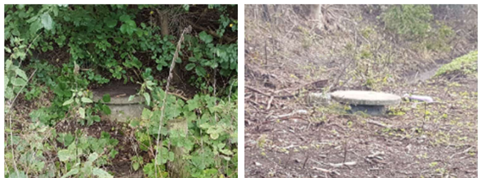
Figur 11: Tv. Gennemløbsbrønd i st. 104 m i Langæblefløbet. Th. gennemløbsbrønd i st. 137 m i Langæblefløbet.
