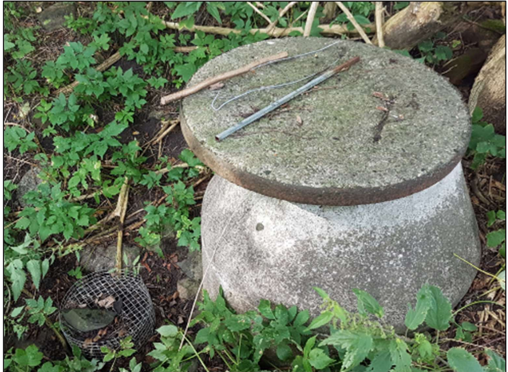
Figur 18: Gennemløbsbrønd i afvandingssystem 2.
