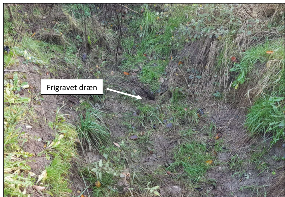
Figur 19: Fritlagt dræn, hvor der tidligere var planlagt etablering af brønd.
