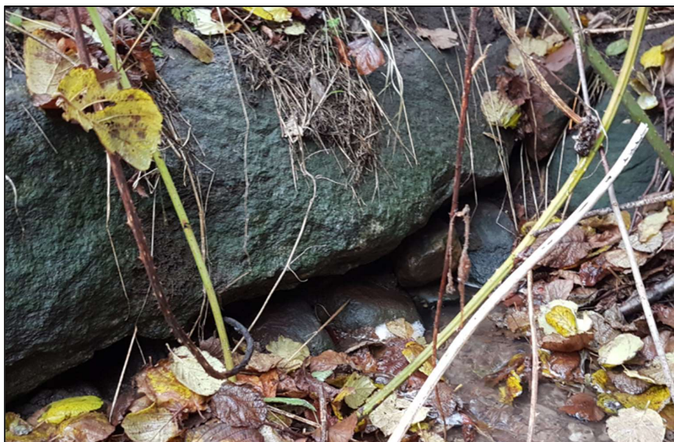
Figur 18: Drænudløb under Lysemosevej til grøften i undersøgelsesområdet.
